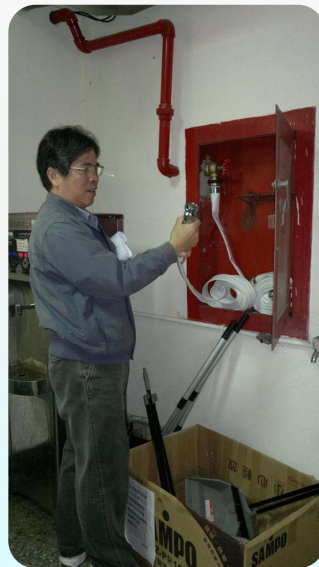
宿舍消防設施定期檢驗
