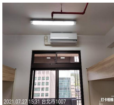
爾雅樓宿舍空調設備
